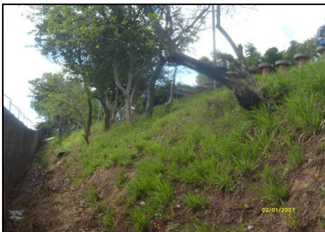
Figura 119. Foto demonstrando um talude com presença de gramínea. Constata-se um sucesso reprodutivo, necessitando de manutenção e fomento.
