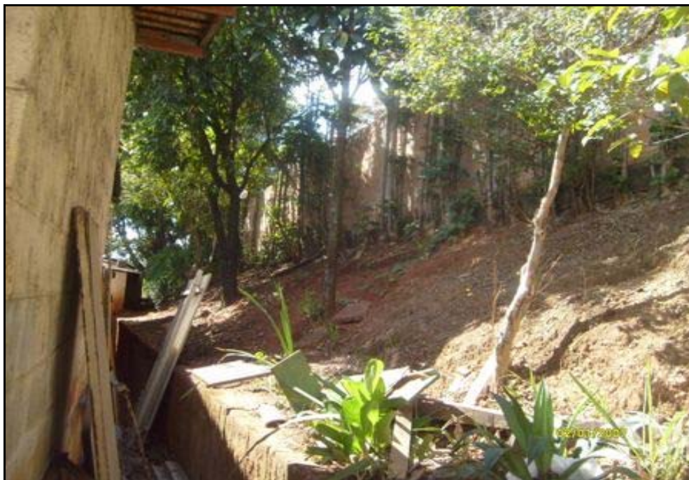
Figura 29. Vista parcial de um talude com baixo revestimento de gramíneas, sujeito à grande escorrimento superficial.
