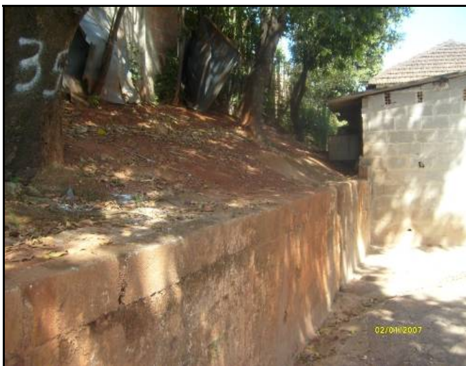
Figura 118. Foto demonstrando um talude com ausência de gramíneas, necessitando de fomento e manejo intensivo.
