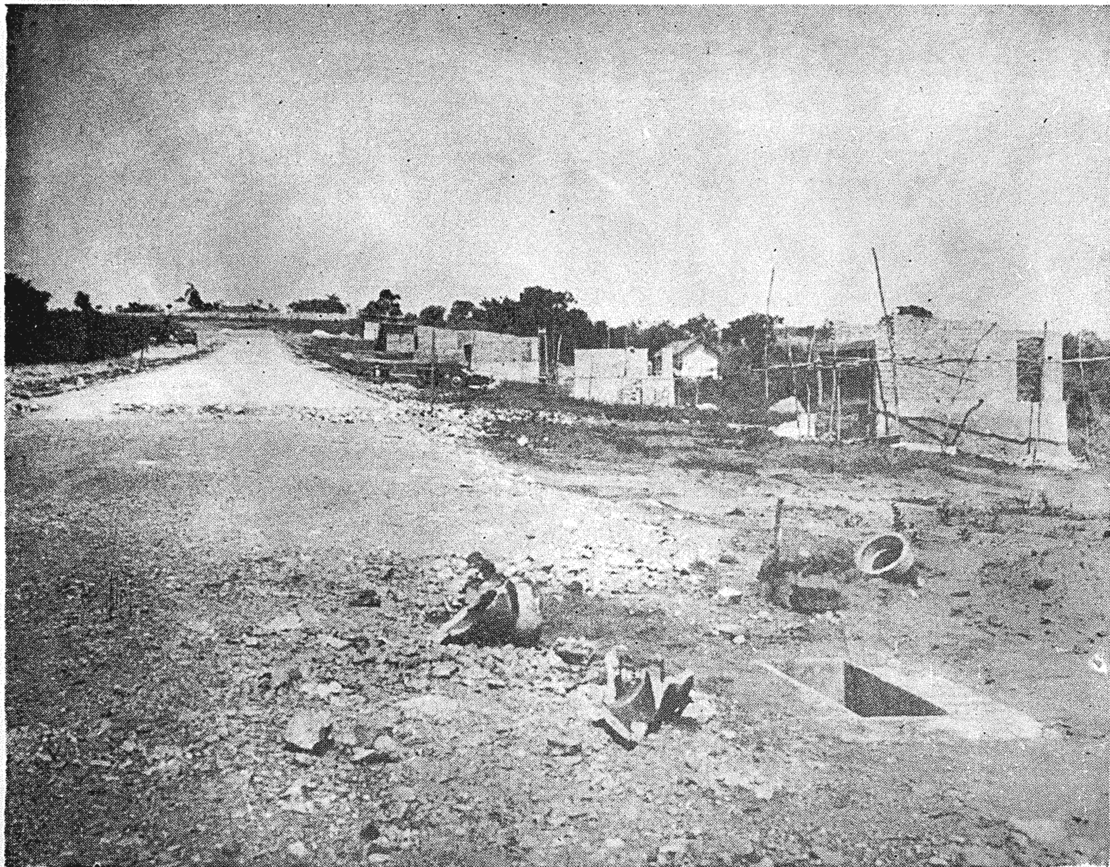
ALAMEDA PRINCIPAL — No centro do Zoo constroi-se uma grande avenida em cujas margens se localizam algumas das numerosas jaulas. (Vista parcial das obras).
