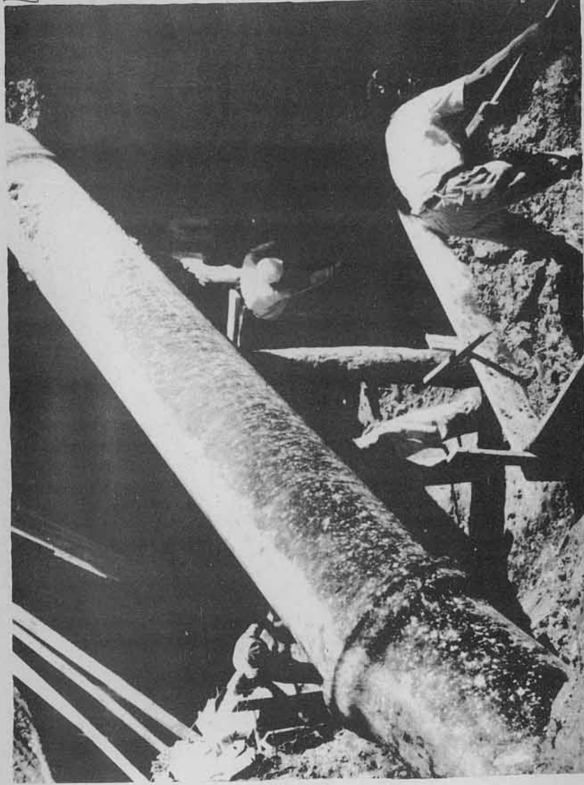
Barroca produzida por um acidente na adutora do Mutuca.
