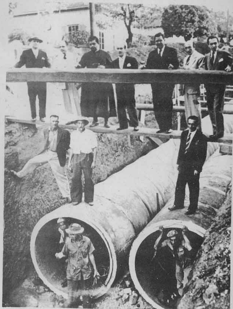
Visita do Prefeito e do presidente da Camara Municipal às obras de canalização do Acaba Mundo, na rua Professor Moraes.
