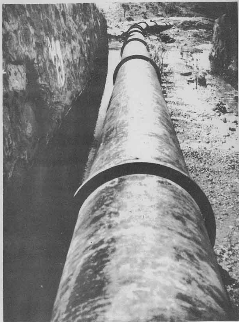
Uma vista da adutora do Mutuca, na boca Norte do Tunel do Rabelo.
